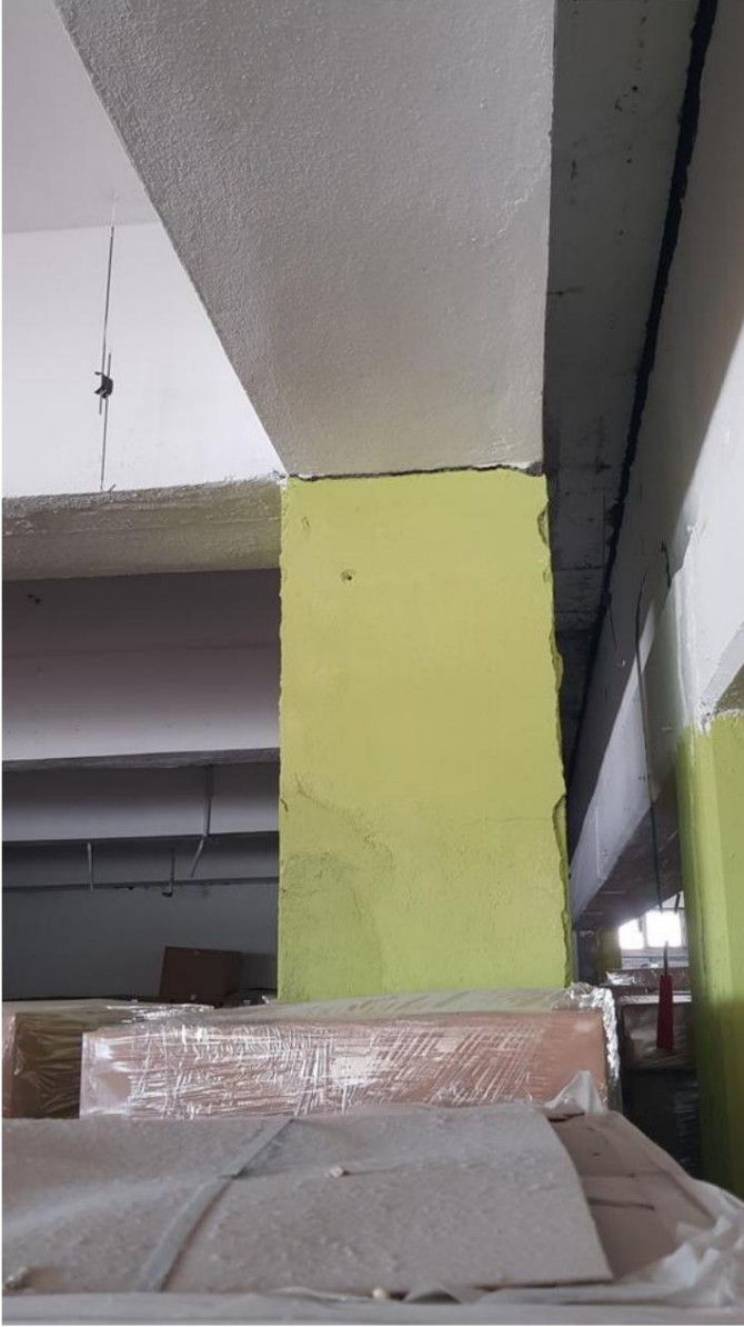
Ek 33 (Depoda hasarlı kiriř.jpg) Denetçi yorumları ve bulguları - Saęlık ve Gvenlik Sayfa 56
